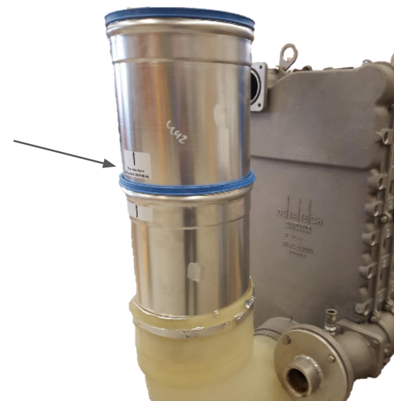
Due silenziatori montati su caldaia con 5 sezioni (Compact Condens 340)
